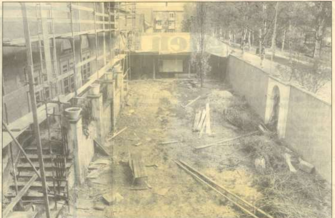
Galler för fönstren ut mot gården är en förutsättning för att dyrbara utställningar skall kunna visas på Aguéli-museet.
